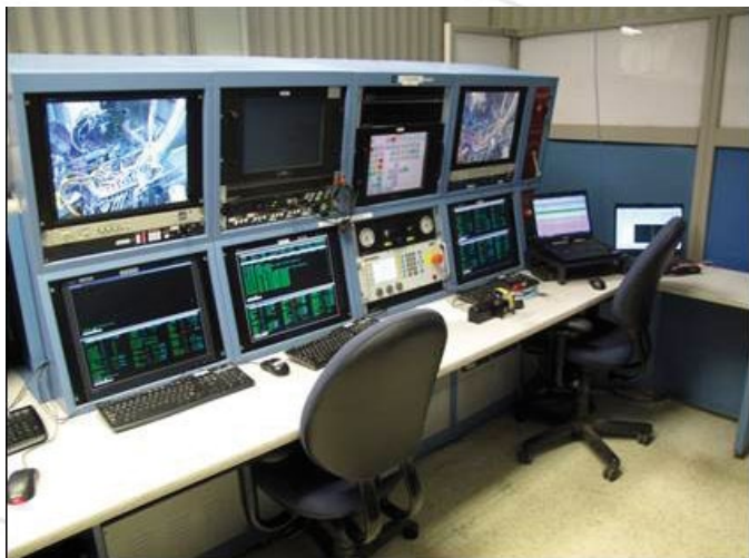
Salle de contrôle du banc d'essai
